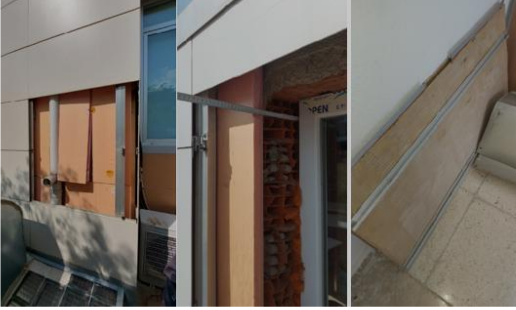
Şekil 8. SKS Menza Yerleşkesi Dış Cephe Bozulma Örnekleri
