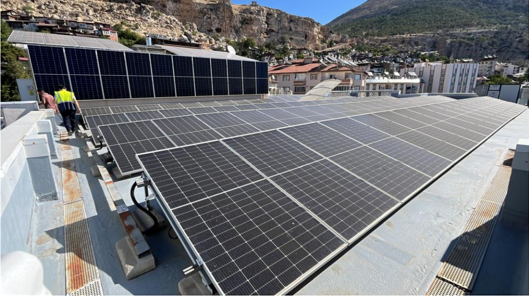
Fotoğraf 11 Bina Çatısında Bulunan GES Sistemi – 2
