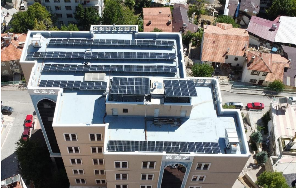
Fotoğraf 12 Bina Çatısında Bulunan GES Sistemi – 3
