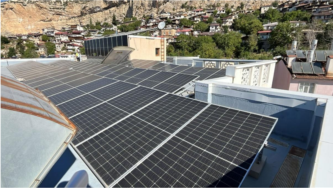
Fotoğraf 10 Bina Çatısında Bulunan GES Sistemi - 1
