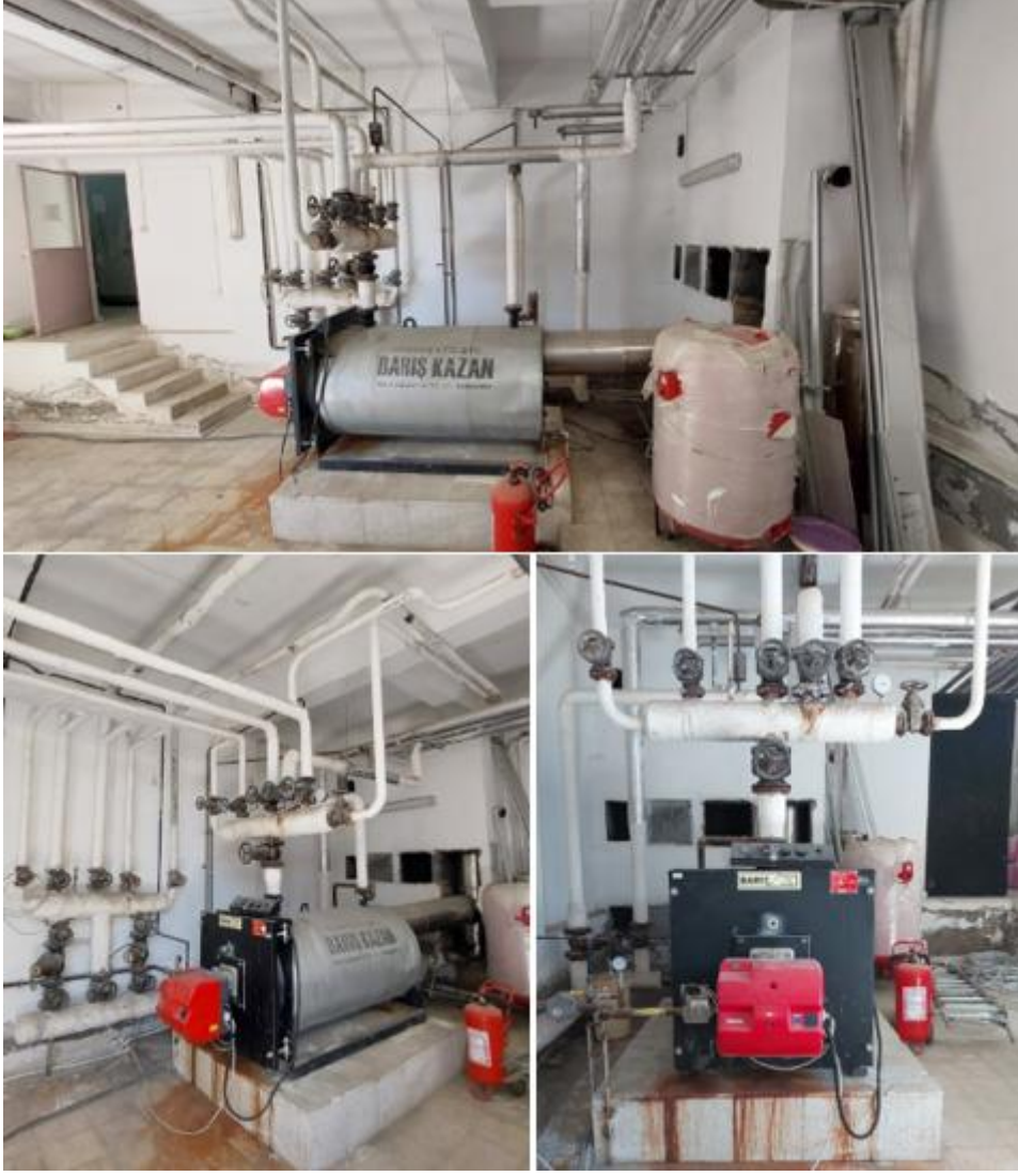
Şekil 9. Emekevler Mesleki ve Teknik Anadolu Lisesi A Blok Isı Merkezi Kazan Görünümü
