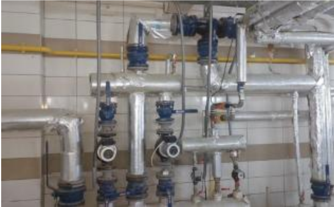
Şekil 8. Burdur Çevre ve Şehircilik İl Müdürlüğü Sirkülasyon Pompaları ve Hidrolik Devresi
