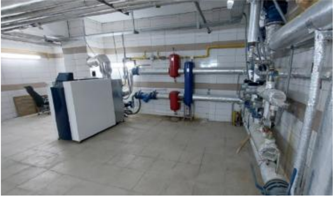
Şekil 7. Burdur Çevre ve Şehircilik İl Müdürlüğü Isı Merkezi Kazan Görünümü
