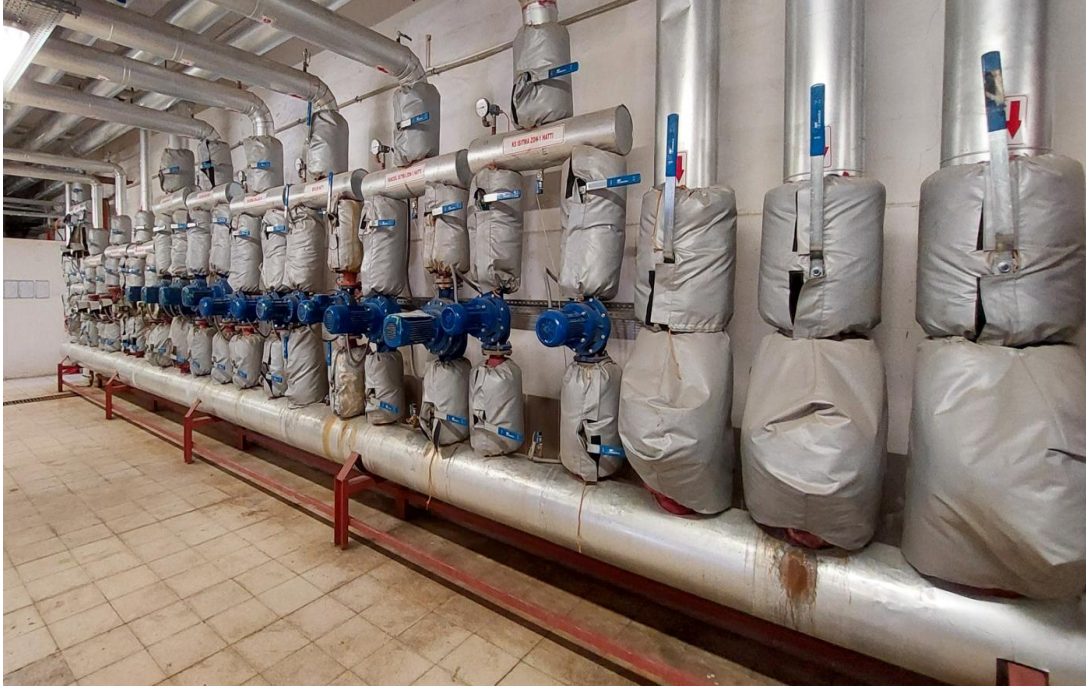
Şekil 8. Isıtma Sirkülasyon Pompalarının Görünümü
