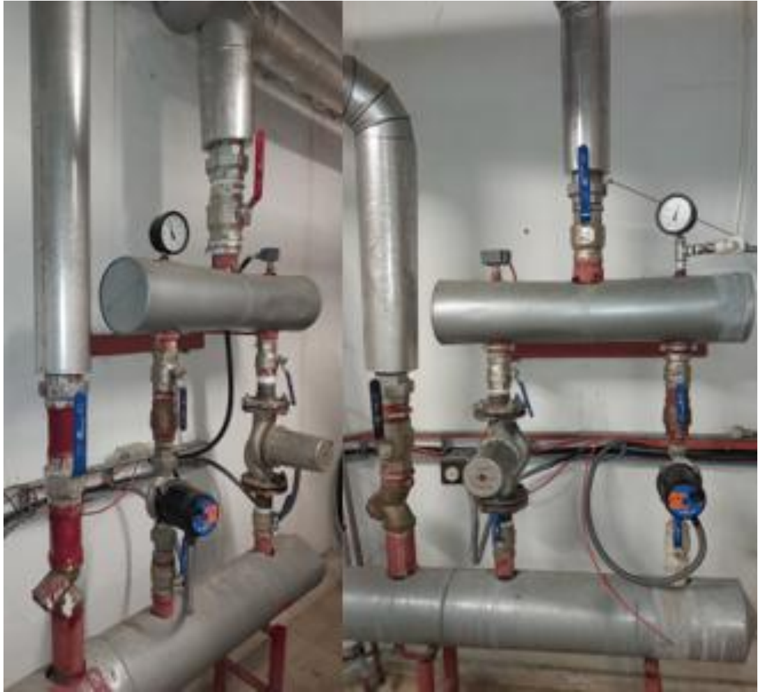
Şekil 9. Sıcak Kullanım Suyu Sirkülasyon Pompalarının Görünümü
