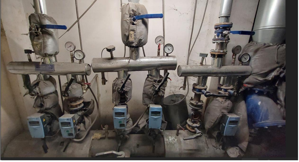
Şekil 8. Isıtma Sirkülasyon Pompalarının Görünümü
