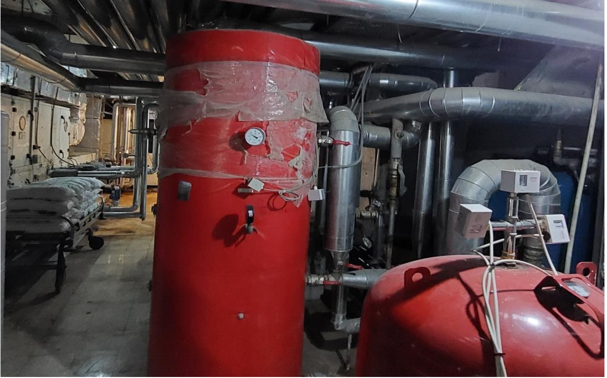
Şekil 9. Sıcak Kullanım Suyu Sistemi Görünümü
