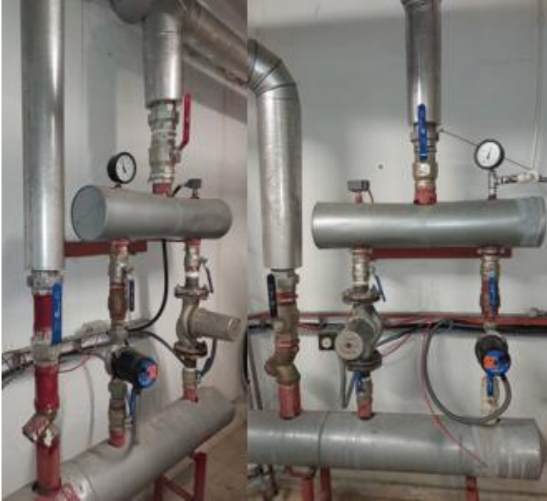
Şekil 9. Sıcak Kullanım Suyu Sirkülasyon Pompaları Görünümü
