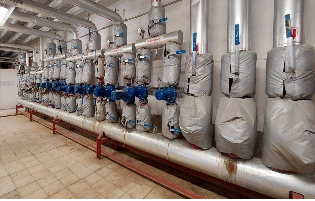
Şekil 8. Isıtma Sirkülasyon Pompaların Görünümü
