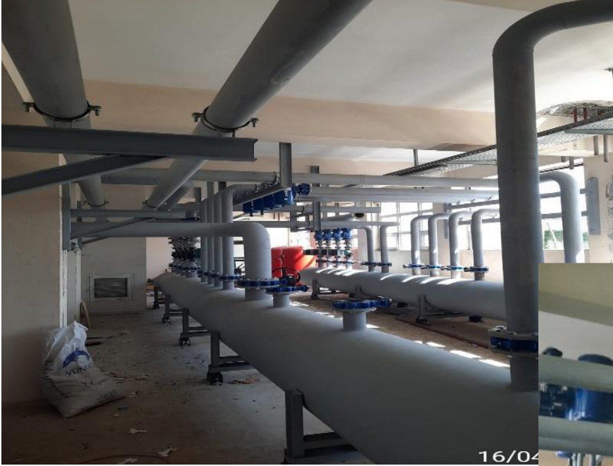
Mühendislik Fakültesi pompa grubu yenilenmesi
