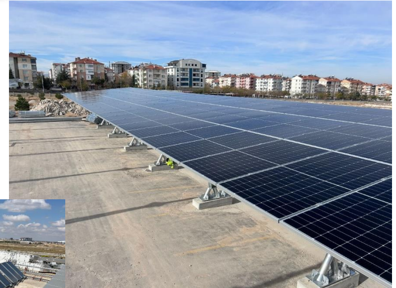
Otopark GES Uygulaması (750kW)
