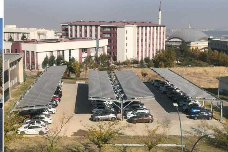
Otopark güneş enerji sistemi
