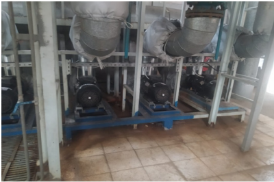
Resim 4. Mekanik tesisat ve Pompalar (Öncesi ve Sonrası)
