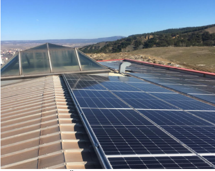
Resim 9. Çatı Üstü Fotovoltaik Panel Sistemi (PV)
