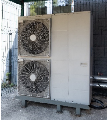
Resim 5. Güneş PV sistemi ile desteklenen ısı pompası uygulaması
