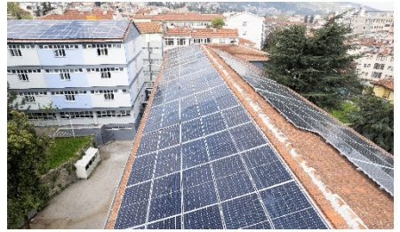
Resim 4. Çatı üstü güneş fotovoltaikleri (PV)
