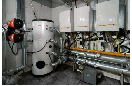
Resim 7. Kazan Dairesi (Kazanlar, Pompalar, Yalıtım) - Öncesi ve Sonrası
