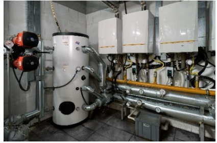
Resim 6. Kazan Dairesi (Sıcak Kullanım Suyu Tankı) - Öncesi ve Sonrası
