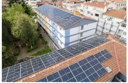
Resim 9. Çatı üstü güneş fotovoltaikleri (PV)
