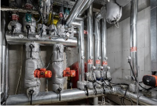
Resim 6. Kazan Dairesi (Kazanlar, Pompalar, Yalıtım) - Öncesi ve Sonrası
