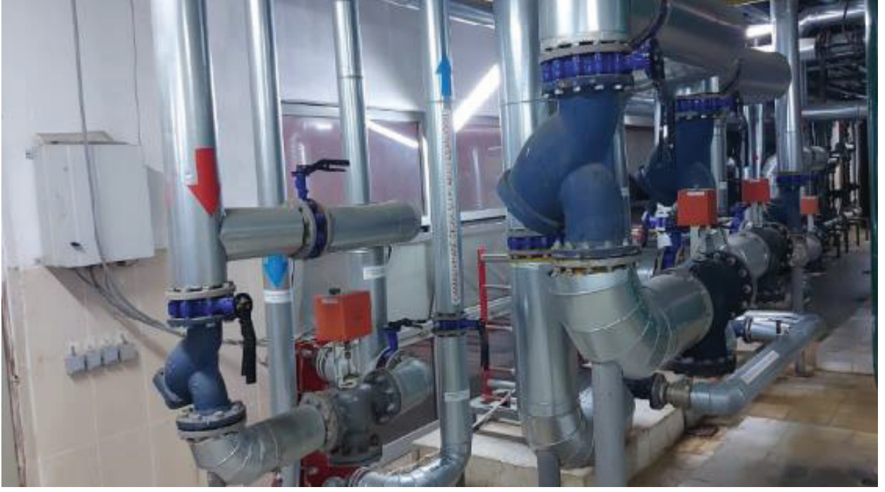
Fotoğraf 11. Doğu Karadeniz Yurt Müdürlüğü Sıcak Su Kullanımı Isıtma Sistemi Pompaları Görünümü
