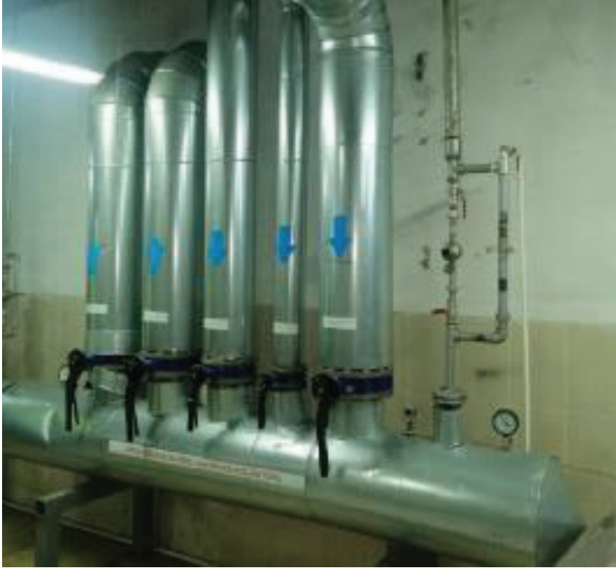
Fotoğraf 15. Doğu Karadeniz Yurt Müdürlüğü Mekanik Oda Isıtma Tesisatı Yalıtım Yapısı Görünümü
