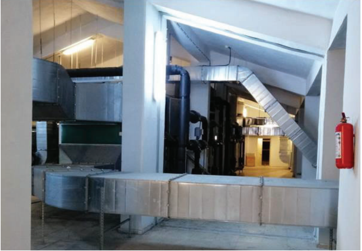
Fotoğraf 13. Rize Kaçkar Devlet Hastanesi Klima Santralleri Havalandırma ve Tesisat Görüntüsü
