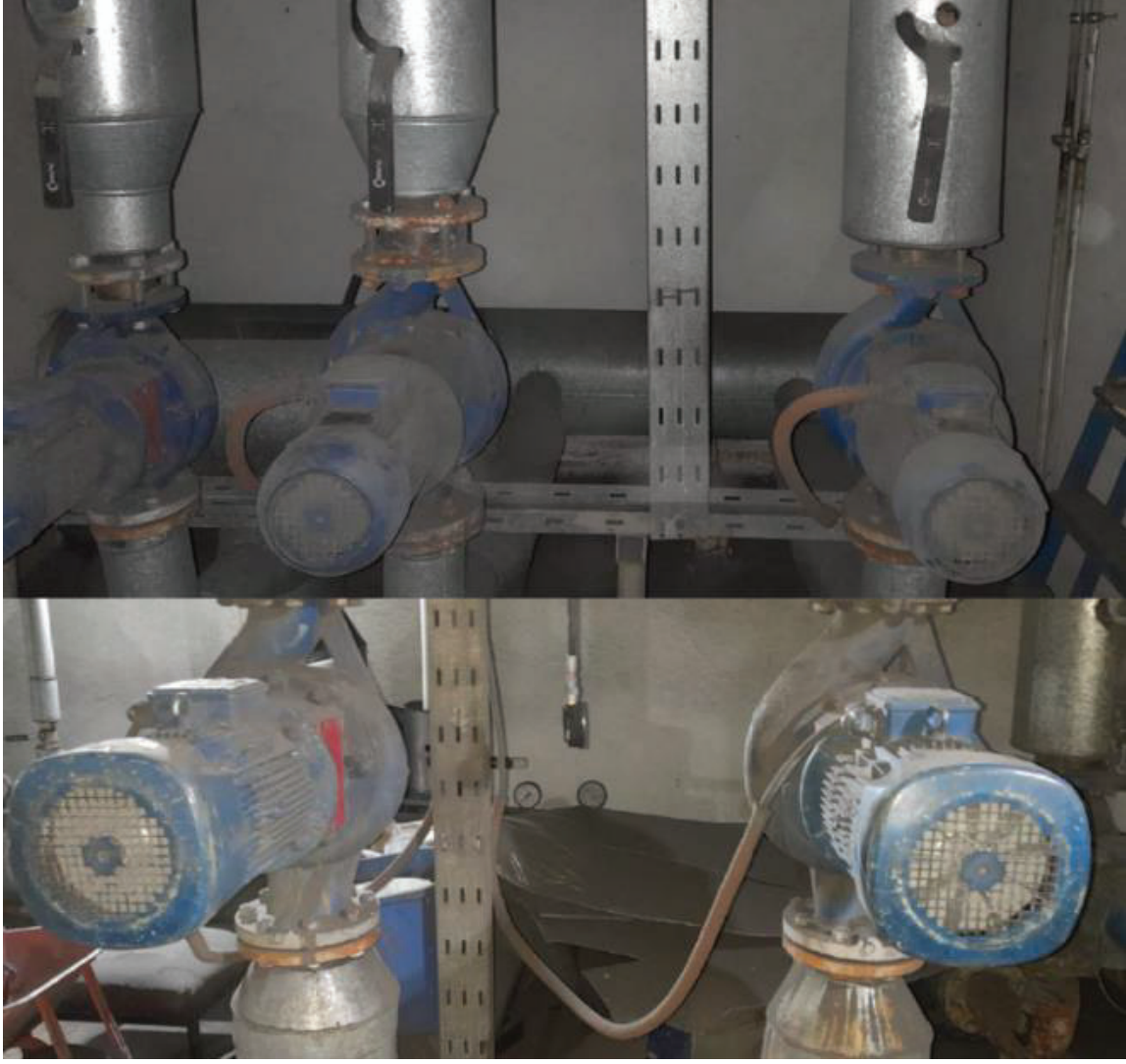
Fotoğraf 8. Rize Kaçkar Devlet Hastanesi Kazan Isıtma Sistemi Pompaları Görünümü
