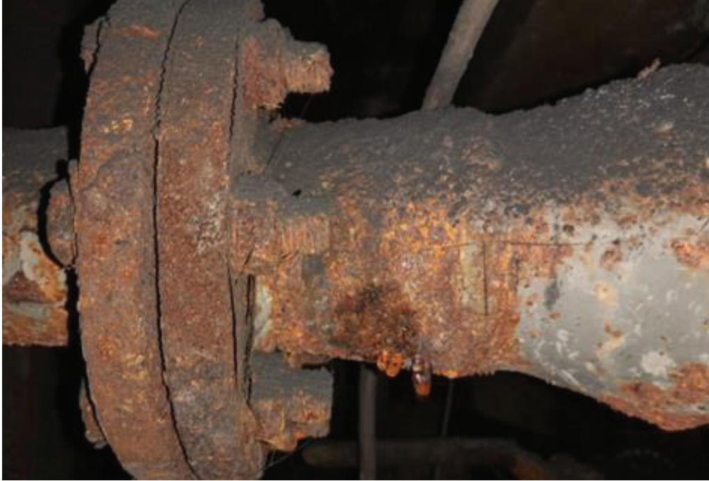
Fotoğraf 12. Rize Kaçkar Devlet Hastanesi Tesisat Dış Korozyon Oluşum Tespitleri Görüntüsü
