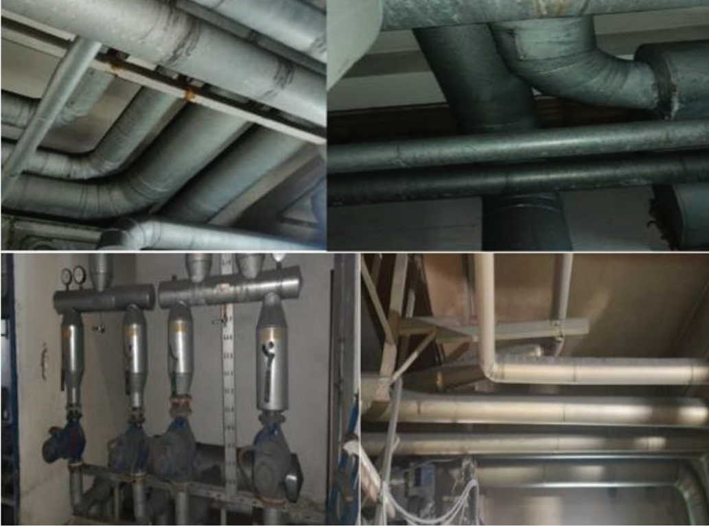
Fotoğraf 11. Rize Kaçkar Devlet Hastanesi Mekanik Oda Isıtma Sıak Su ve Soğutma Tesisatı Yalıtım Yapısı Görünümü
