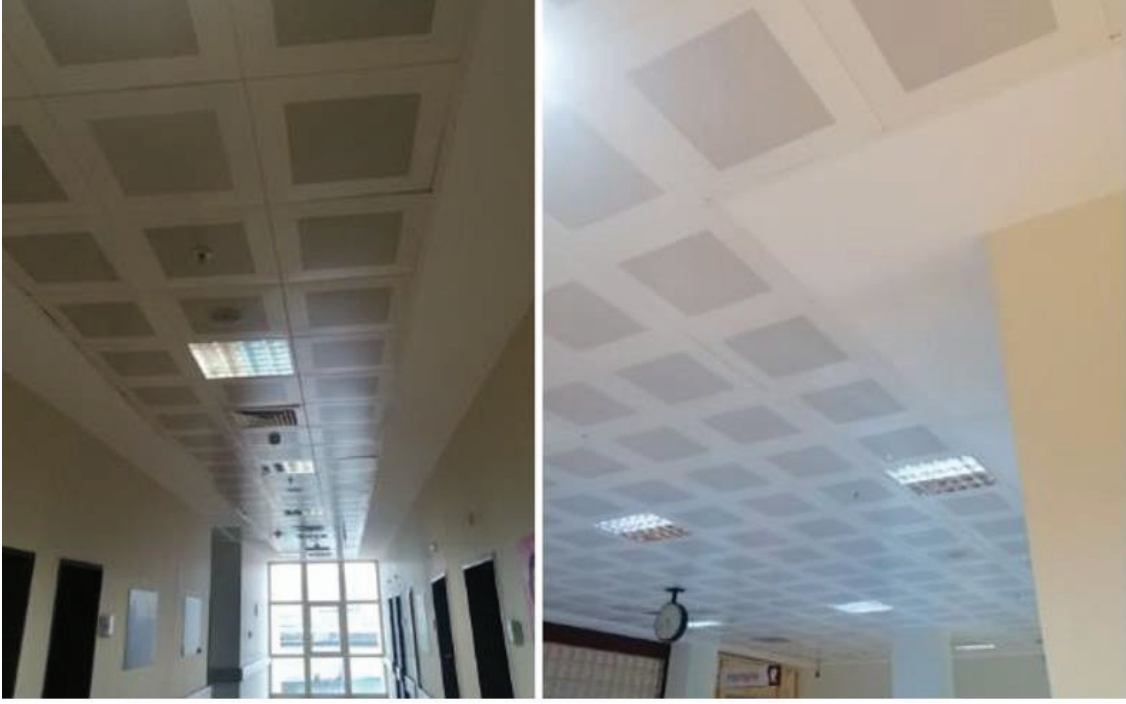
Fotoğraf 14. Rize Kaçkar Devlet Hastanesi 1. Kat A Blok Koridor Aydınlatma Armatür Örnekleri
