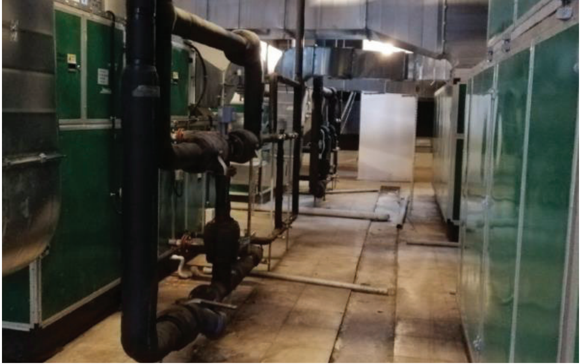
Fotoğraf 9. Rize Kaçkar Devlet Hastanesi Klima Santrali Isıtma Bataryası 3 Yollu Vana Durumu Görünümü
