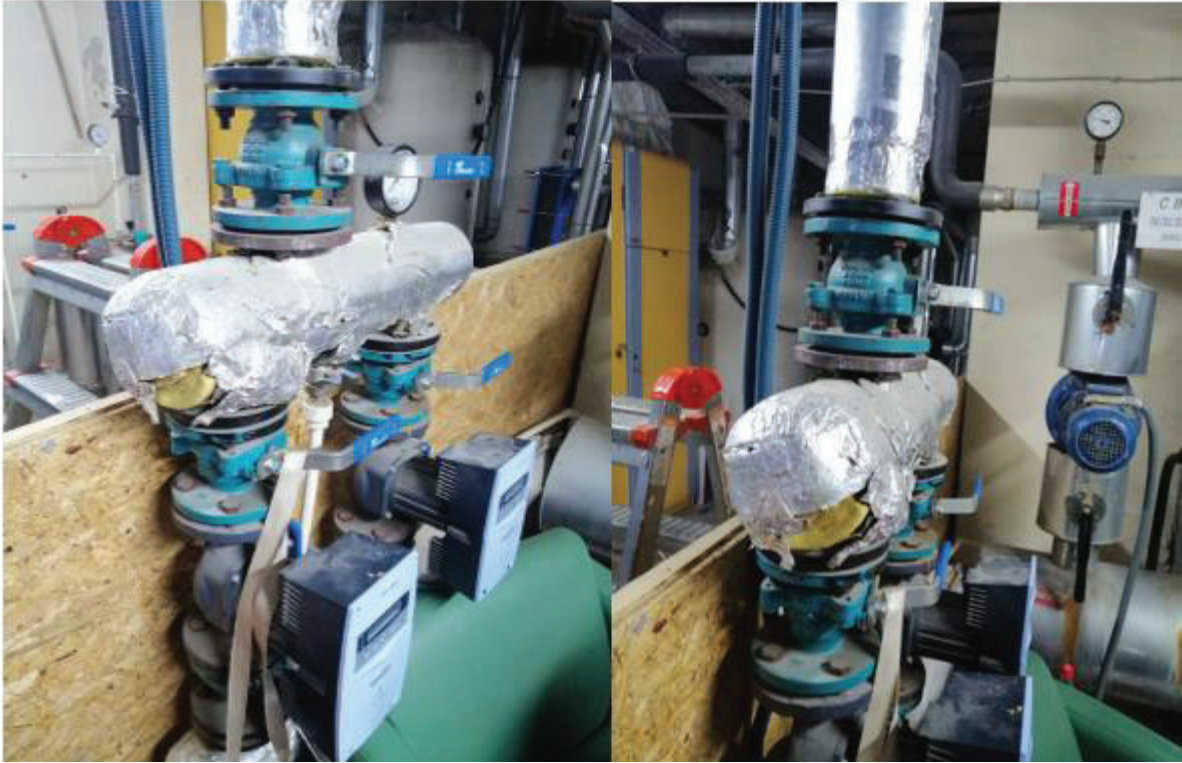
Fotoğraf 17. Rize Devlet Hastanesi Sonradan Dahil Edilen A Blok Dahiliye Klima Santrali Hattı Görünümü
