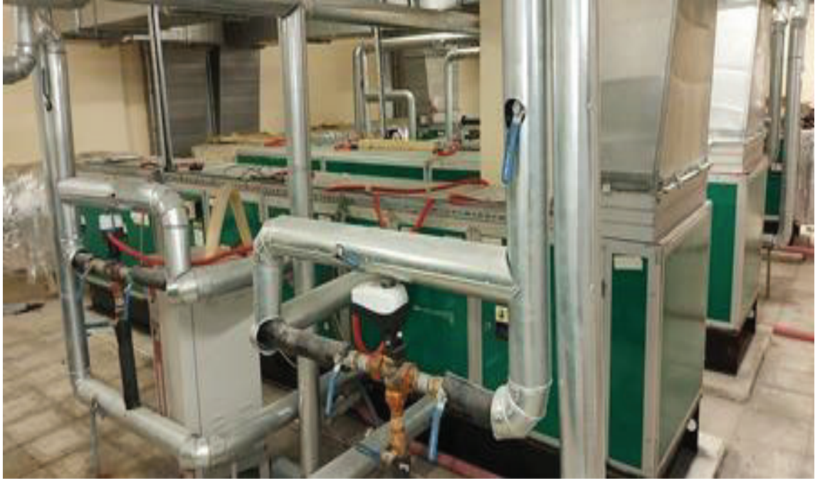
Fotoğraf 12. Rize Devlet Hastanesi Klima Santrali Isıtma Bataryası 3 Yollu Vana Durumu Görünümü
