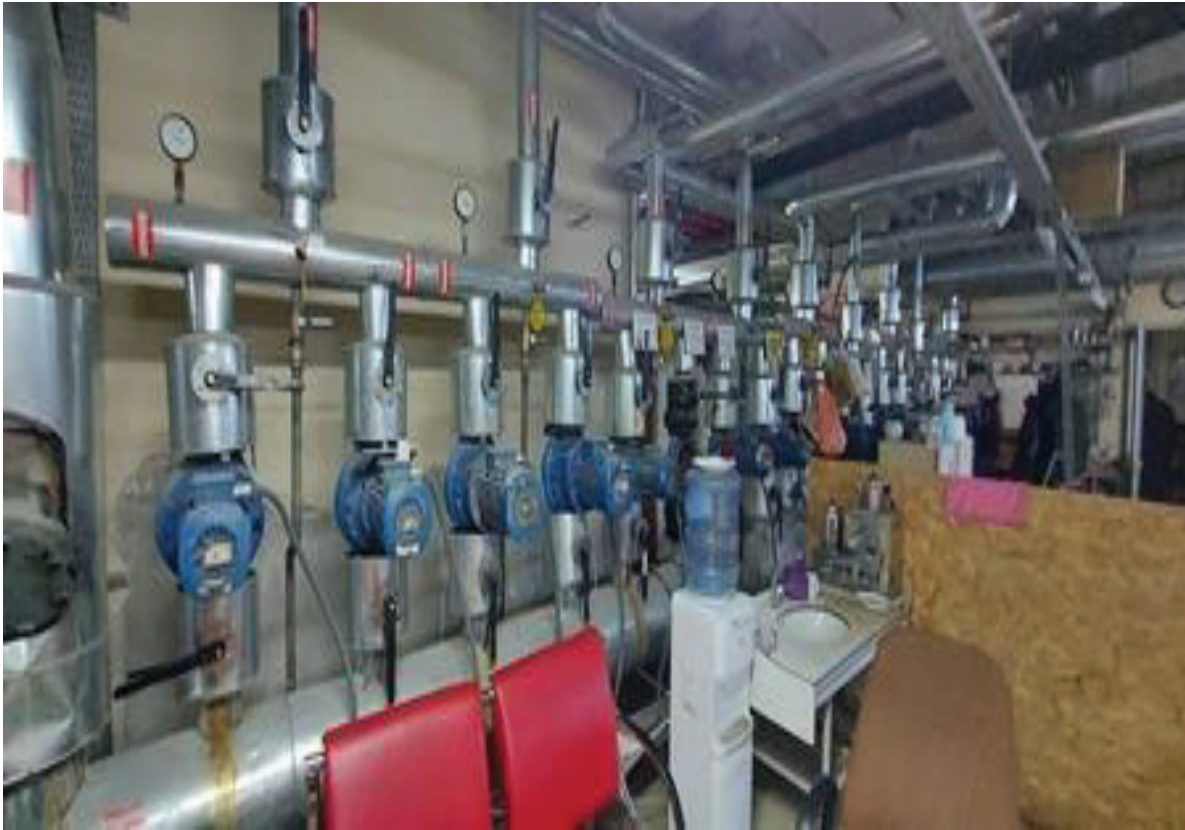
Fotoğraf 11. Rize Devlet Hastanesi Kazan Isıtma Sistemi Pompaları Görünümü
