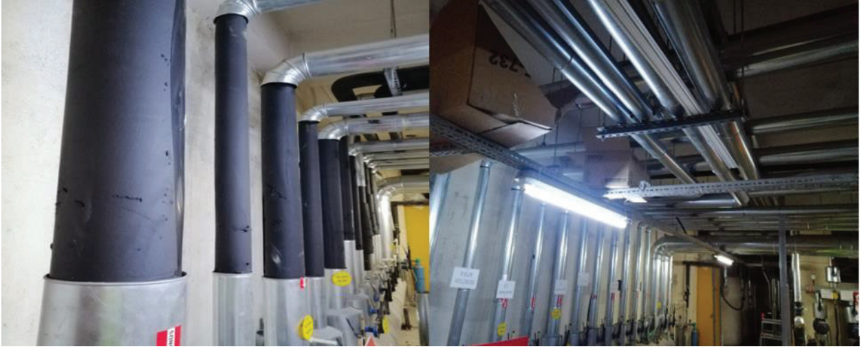
Fotoğraf 16. Rize Devlet Hastanesi Mekanik Oda Isıtma ve Soğutma Tesisatı Yalıtım Yapısı Görünümü
