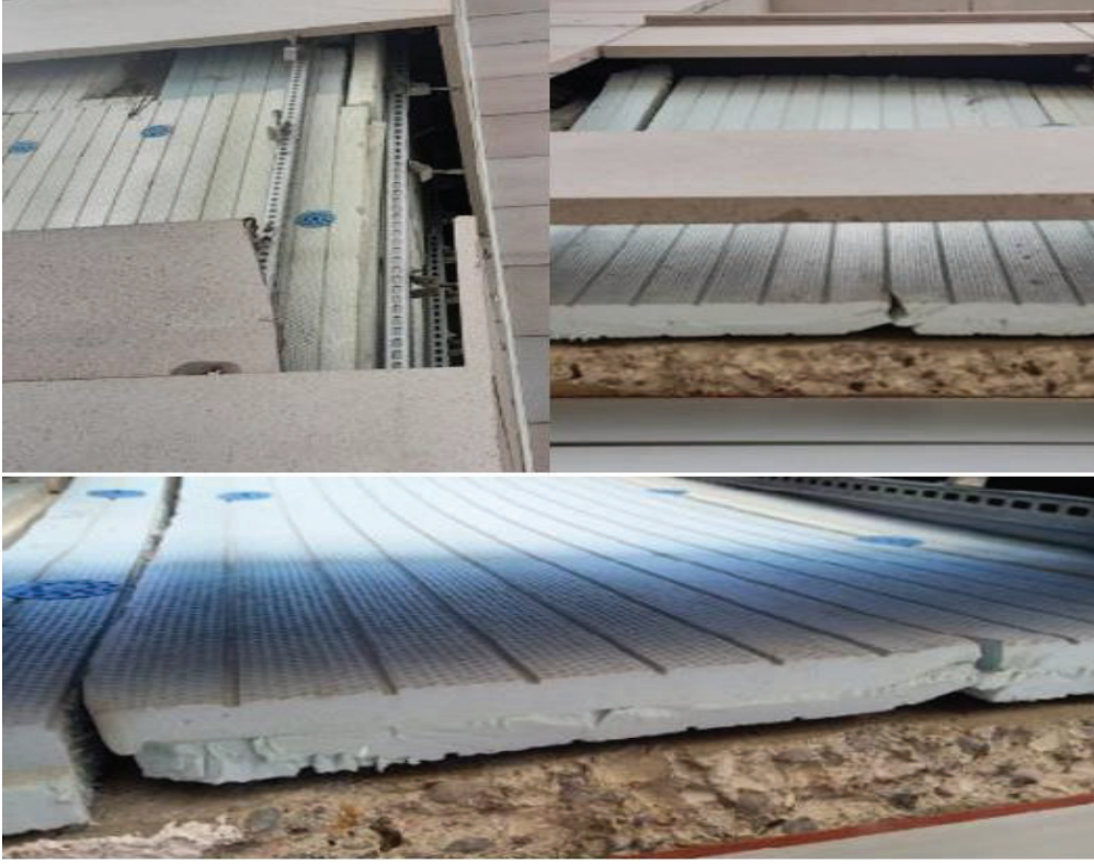
Fotoğraf 3. Giresun Şebinkarahisar Devlet Hastanesi Dış Cephe Yalıtım Görünüm Örnekleri
