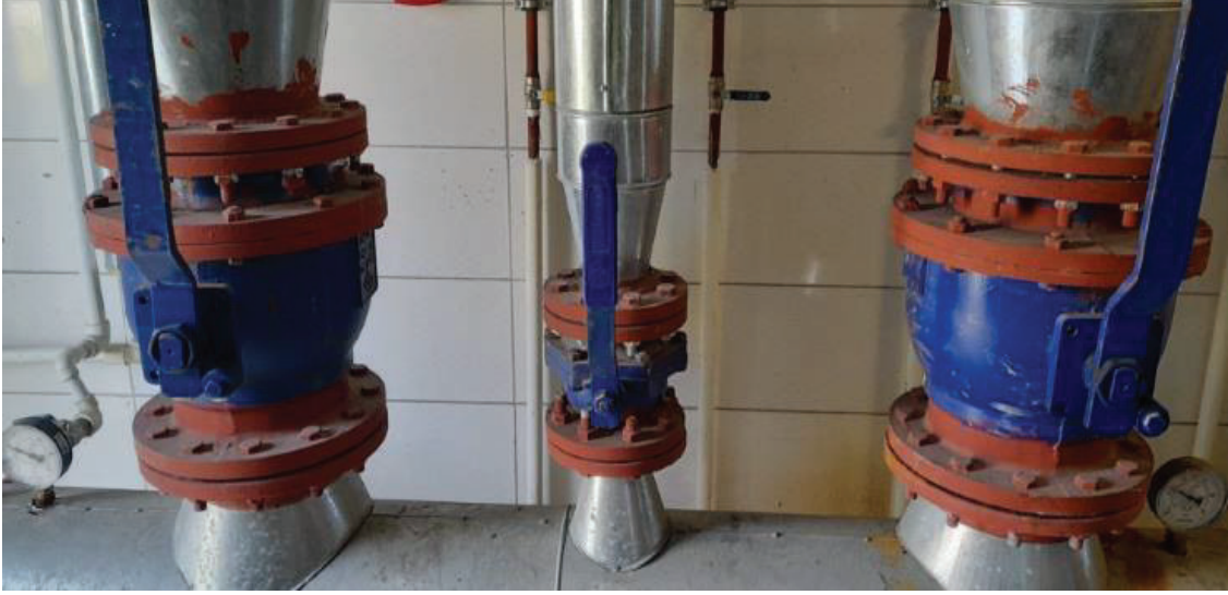
Fotoğraf 12. Giresun Üniversitesi, Fen Edebiyat Fakültesi, İktisadi ve İdari Bilimler Fakültesi Kazan Dairesi Tesisatı Vana Yalıtım Yapısı Görünümü
