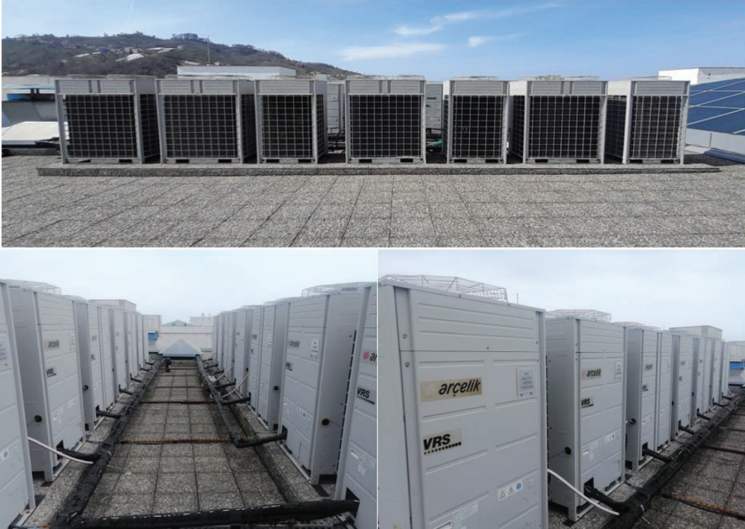
Fotoğraf 11. Giresun Üniversitesi, Fen Edebiyat Fakültesi, İktisadi ve İdari Bilimler Fakültesi VRF Dış Ünite Dış Görünümleri
