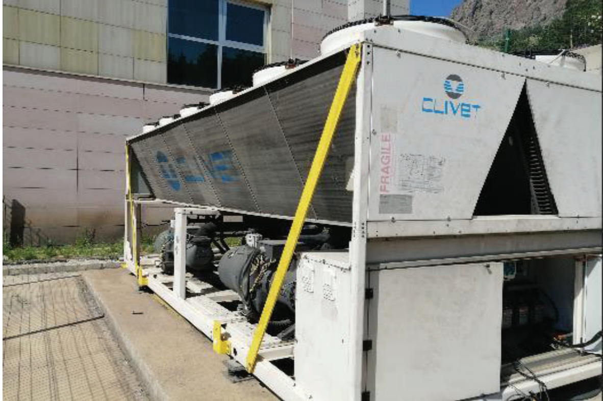
Fotoğraf 12. Giresun Şebinkarahisar Devlet Hastanesi Clivet Hava Soğutmalı Chiller Grup Görünümü
