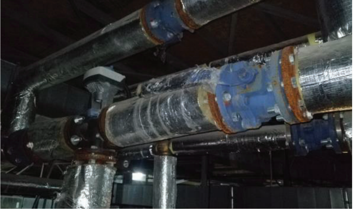
Fotoğraf 11. Giresun Şebinkarahisar Devlet Hastanesi Klima santrali Isıtma Bataryası 3 Yollu Vana Görünümü
