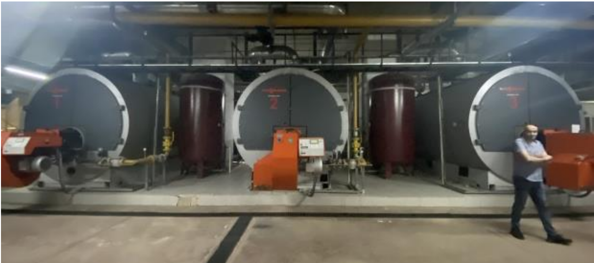
Fotoğraf 7. İstanbul Çağlayan Adalet Sarayı Isıtma Kazanları Genel Görünümü
