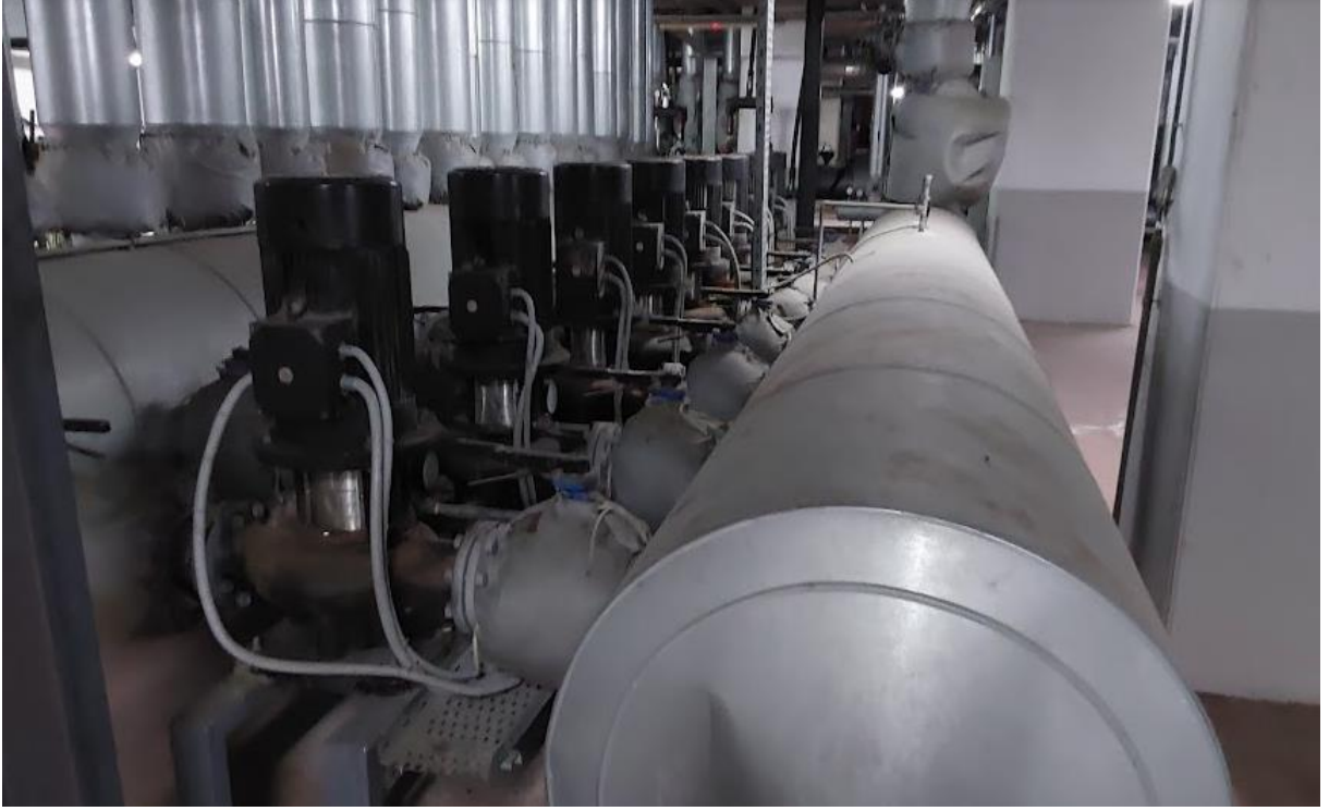
Fotoğraf 8. İstanbul Çağlayan Adalet Sarayı Transfer Pompa Grupları
