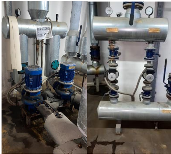
Fotoğraf 5. Isıtma Tesisatı Genel Görünüm
