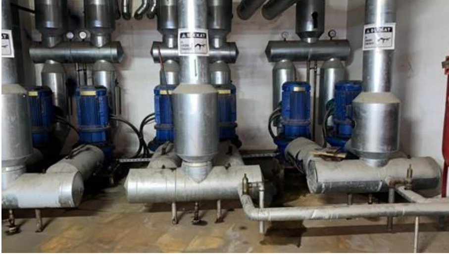
Fotoğraf 4. Chiller Sirkülasyon Pompaları Genel Görünüm
