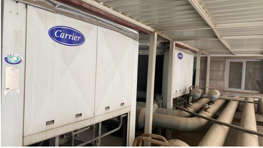
Fotoğraf 3. Chiller Grupları
