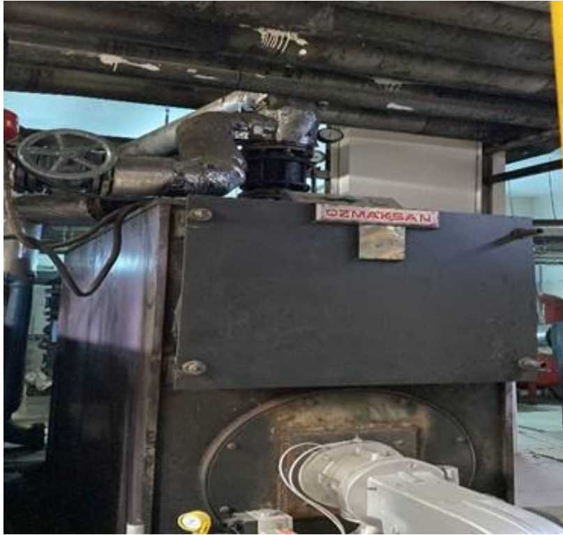
Fotoğraf 3. Isıtma Tesisatı Genel Görünüm
