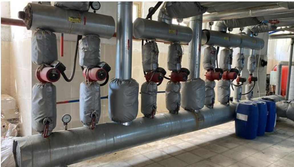
Fotoğraf 5. Isıtma Tesisatı Genel Görünüm
