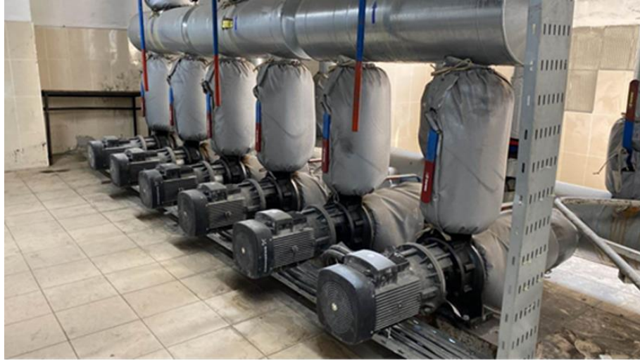
Fotoğraf 4. Chiller Sirkülasyon Pompaları Genel Görünüm
