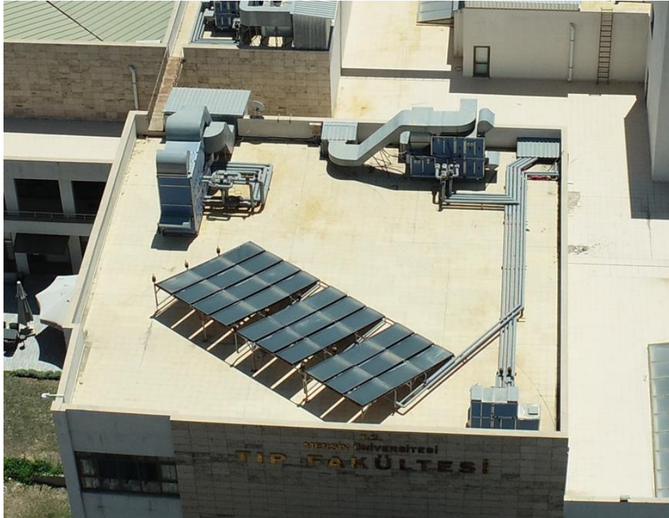
Fotoğraf 7. Güneş Kollektörleri Mevcut Durum
