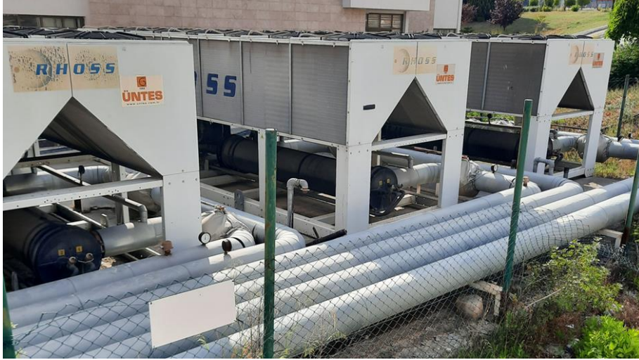
Fotoğraf 3. Chiller Grupları
