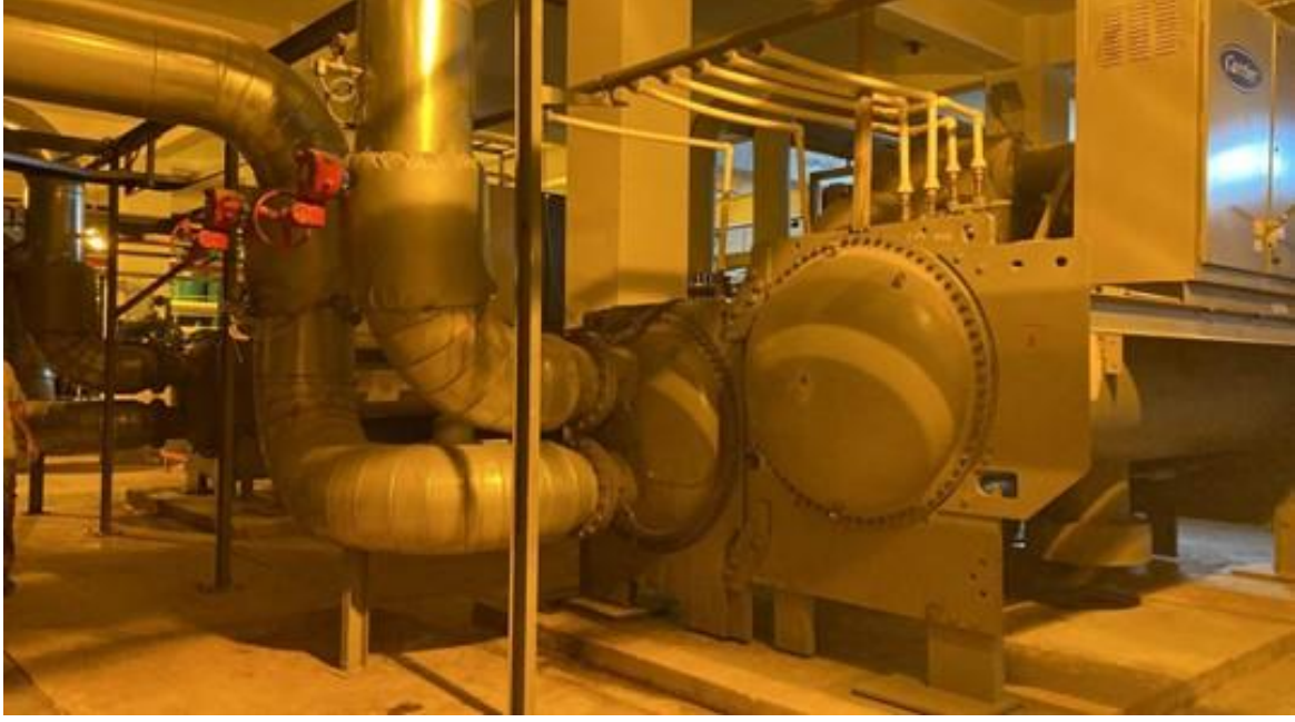
Fotoğraf 3. Chiller Grupları
