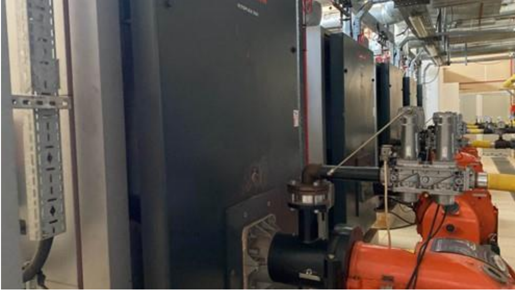
Fotoğraf 5. Isıtma Tesisatı Genel Görünüm
