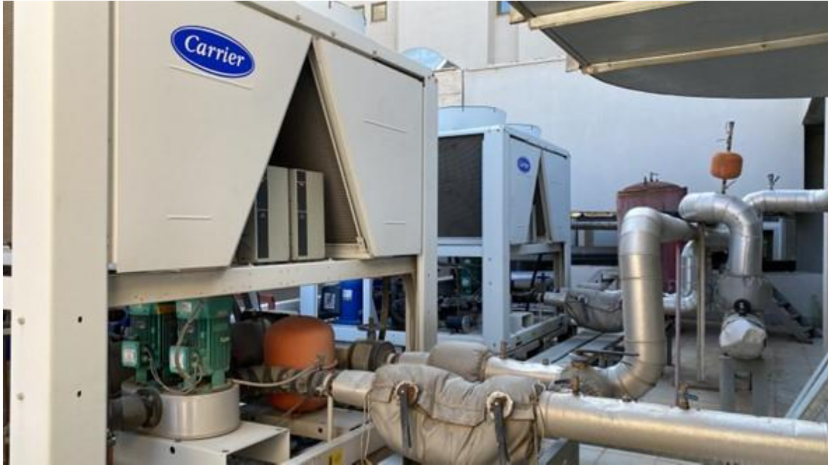
Fotoğraf 4. Chiller Grupları
