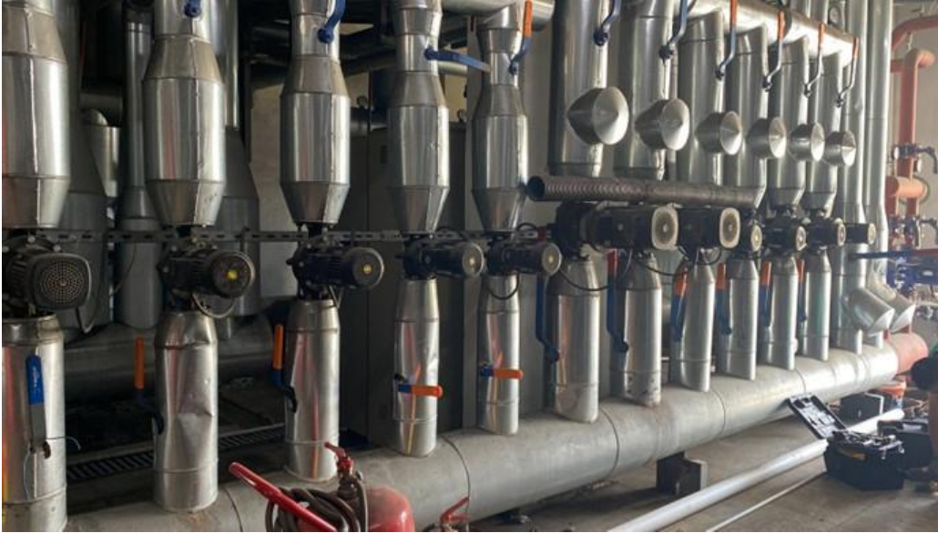
Fotoğraf 5. Isıtma Tesisatı Genel Görünüm
