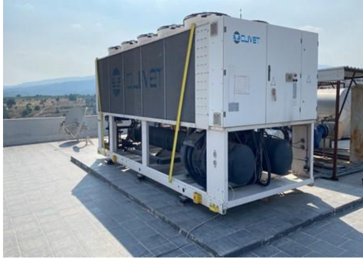
Fotoğraf 3. Chiller Grupları
