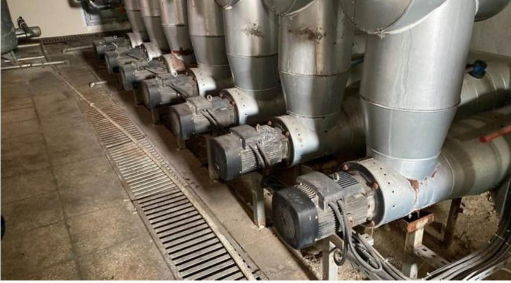
Fotoğraf 4. Chiller Sirkülasyon Pompaları Genel Görünüm
