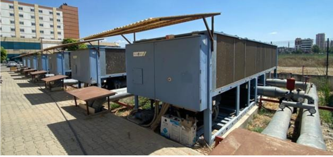
Fotoğraf 3. Chiller Grupları
