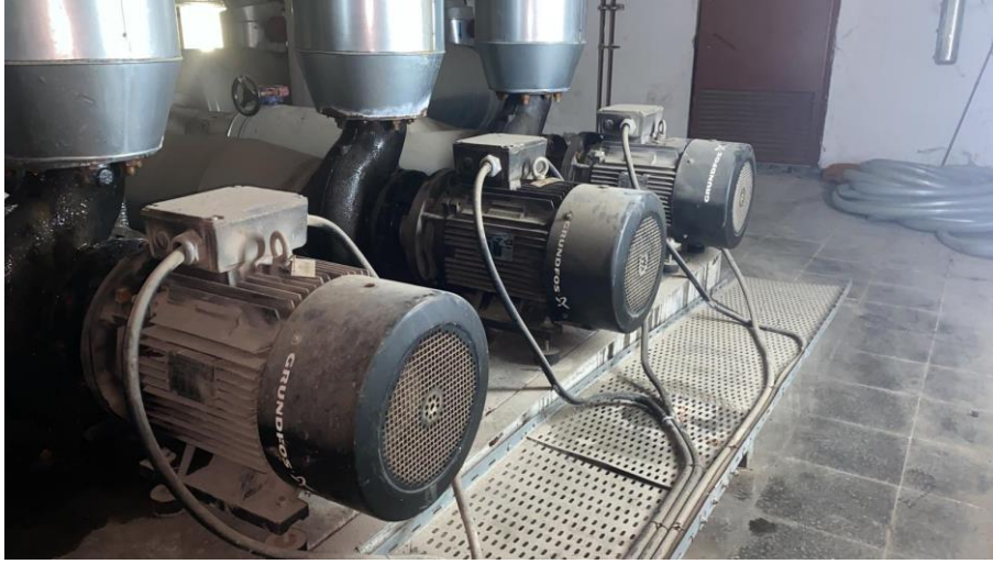
Fotoğraf 4. Chiller Sirkülasyon Pompaları Genel Görünüm
