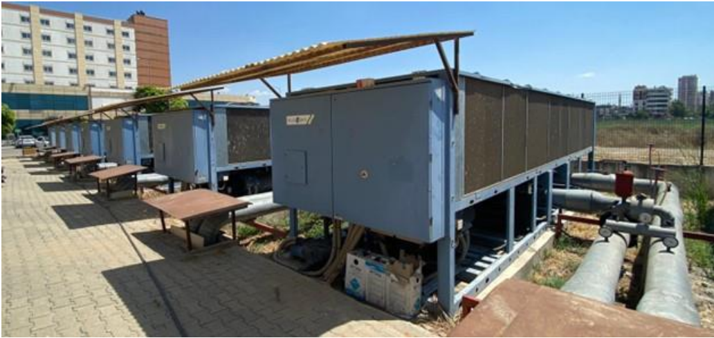
Fotoğraf 5. Chiller Grupları Genel Görünüm
