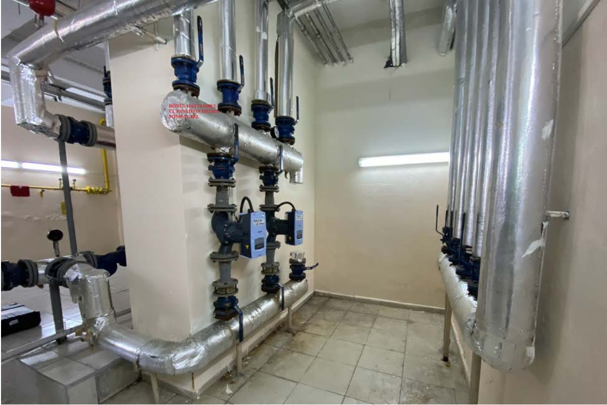
Fotoğraf 9. Vezirköprü Hatice Kemal Kayalıođlu Fen Lisesi Isıtma Sistemi Pompaları Görünümü ve Gidiş Kolektörü
