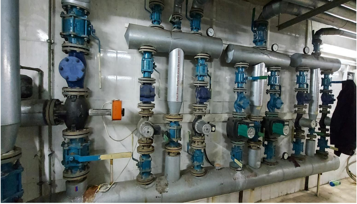
Fotoğraf 5. Bafra Kız Anadolu İmam Hatip Lisesi Isıtma Sistemi Pompaları Görünümü
