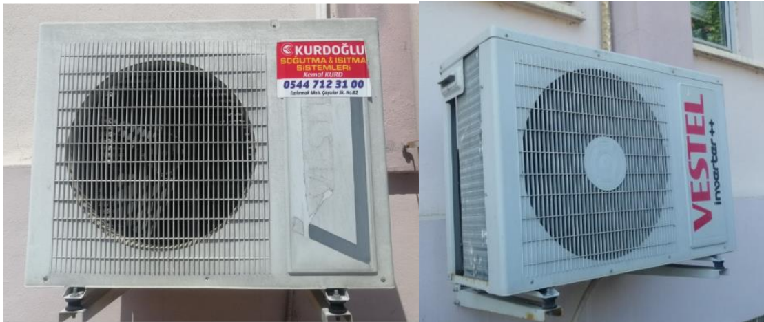
Fotoğraf 8. Bafra Kız Anadolu İmam Hatip Lisesi Okul Binası Split Klima Dış Ünite Görünümleri
