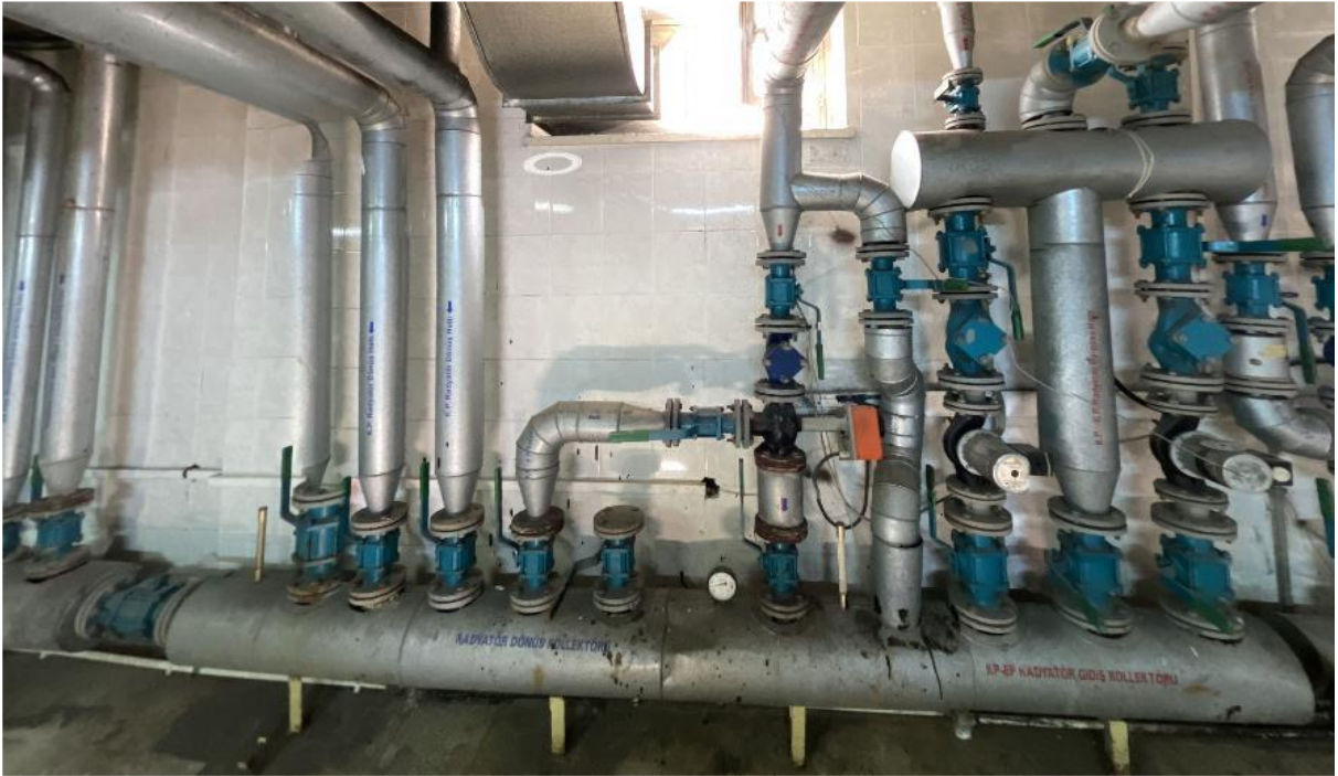
Fotoğraf 6. Bafra Kız Anadolu İmam Hatip Lisesi Pansiyonlar Isıtma Sistemi Pompaları Görünümü ve Dönüş Hattı Kolektörü
