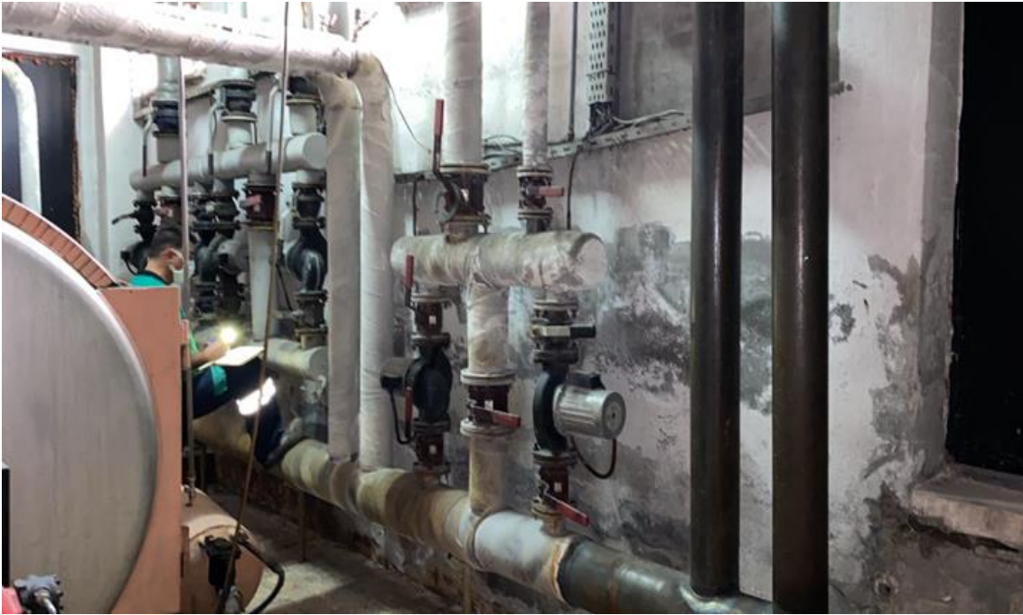
Fotoğraf 6. Gidiş ve Dönüş Kollektörleri Tesisat Genel Görünümü
