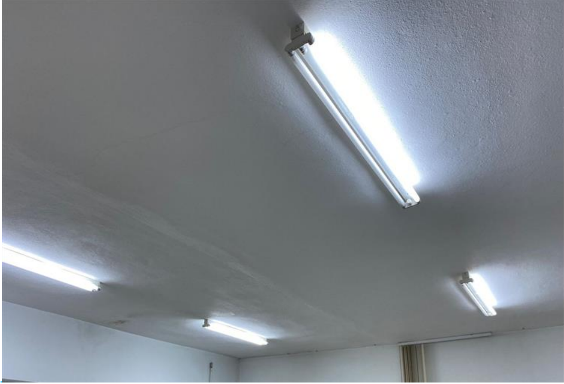
Fotoğraf 5. A Blok Oda Aydınlatması
