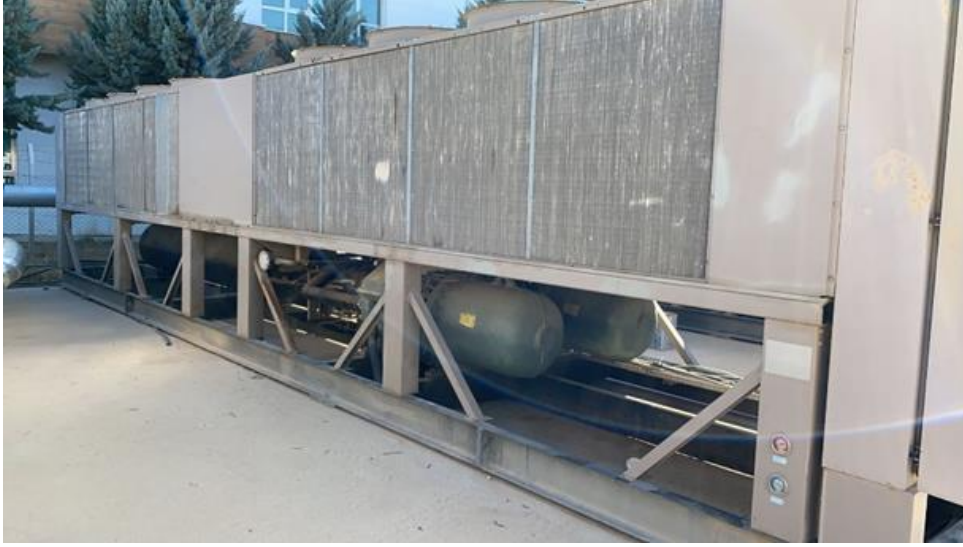
Fotoğraf 6. Chiller Grubu
