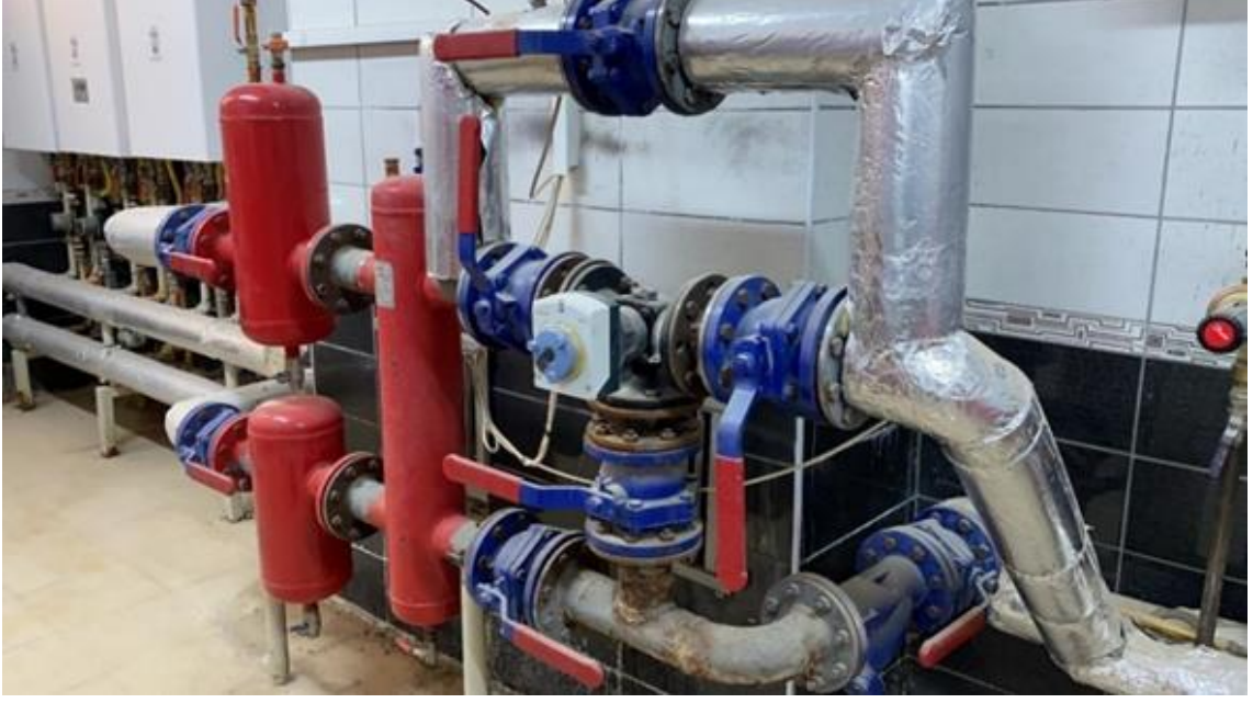
Fotoğraf 6. Yalıtımsız Tesisat Ekipmanları
