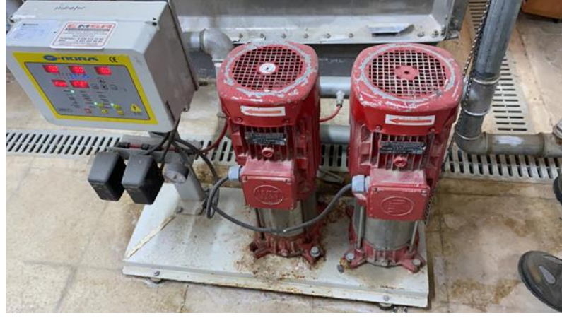
Fotoğraf 4. Hidrofor Pompaları Genel Görünümü
