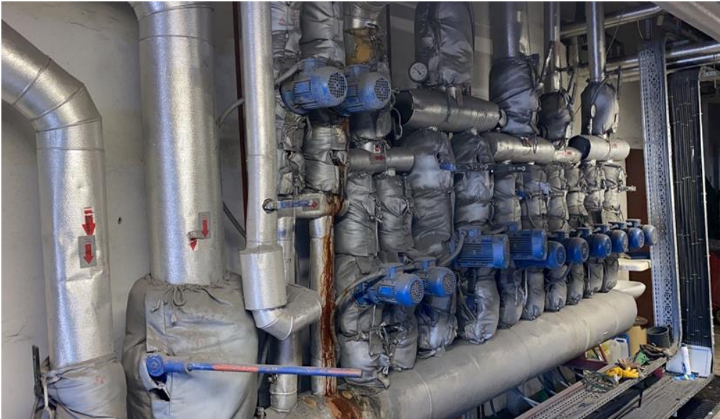
Fotoğraf 5. Isıtma Tesisatı Genel Görünüm
