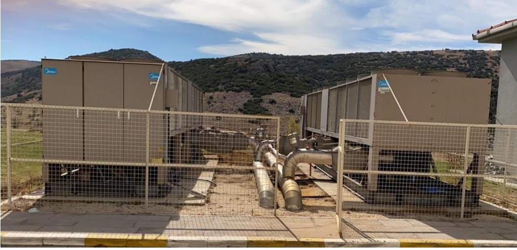
Fotoğraf 3. Chiller Grupları
