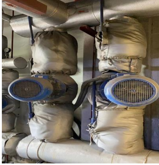
Fotoğraf 4. Chiller Sirkülasyon Pompaları Genel Görünüm
