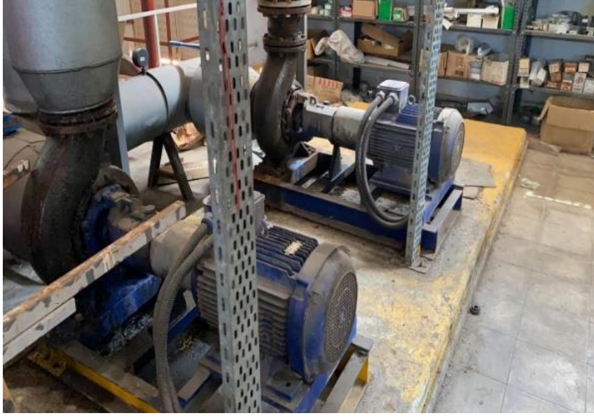
Fotoğraf 3. 7 No.lu Chiller Pompası
