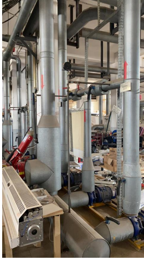
Fotoğraf 4. Isıtma Tesisatı Genel Görünümü
