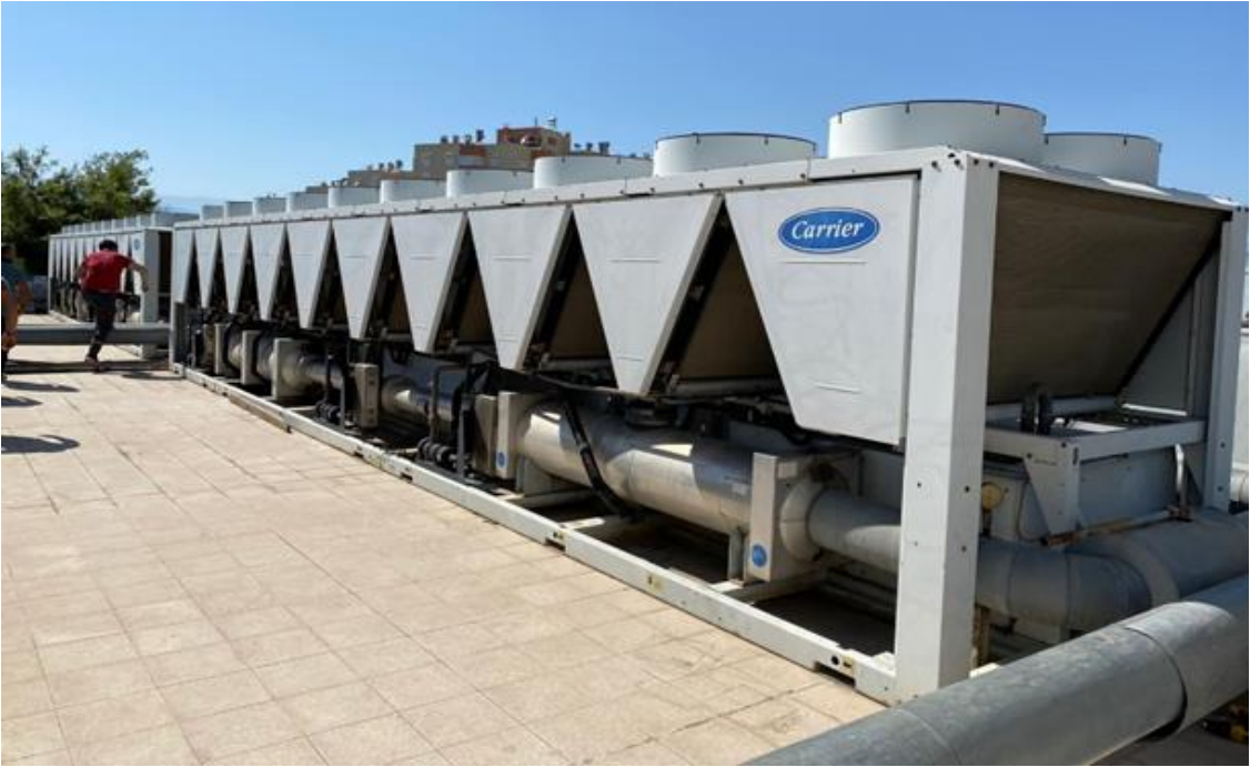
Fotoğraf 2. Chiller Grupları
