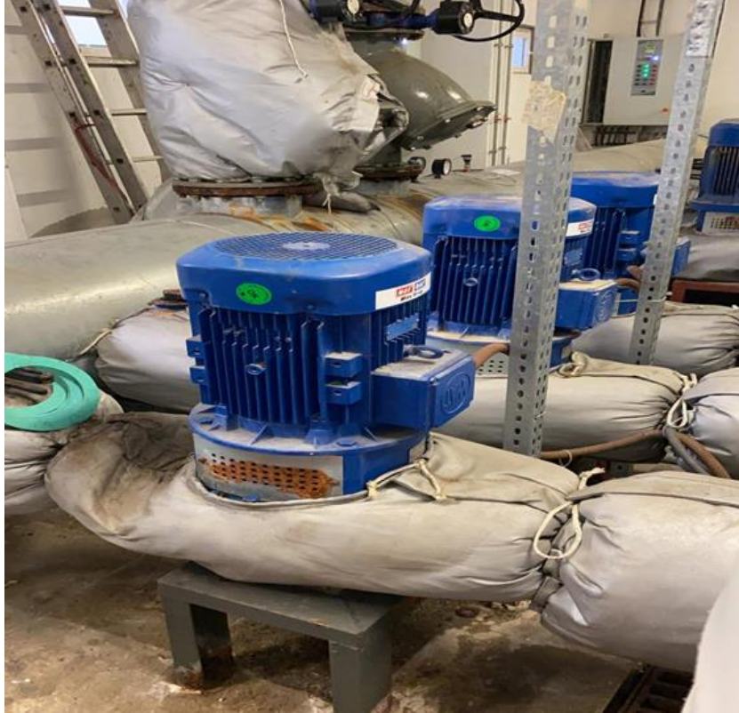
Fotoğraf 6. Santral Soğutma Zon 5 Pompası Genel Görünüm
