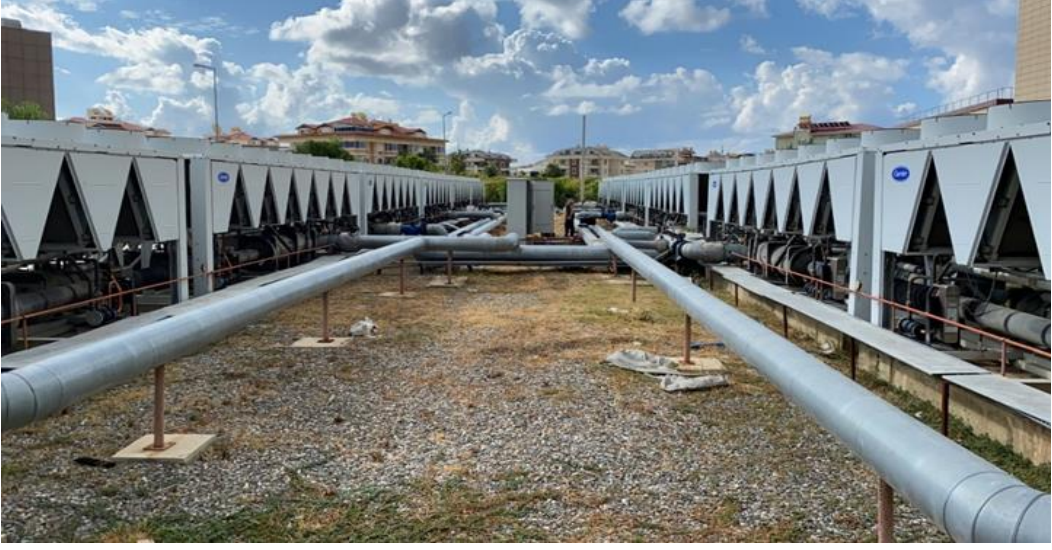
Fotoğraf 3. Chiller Grupları
