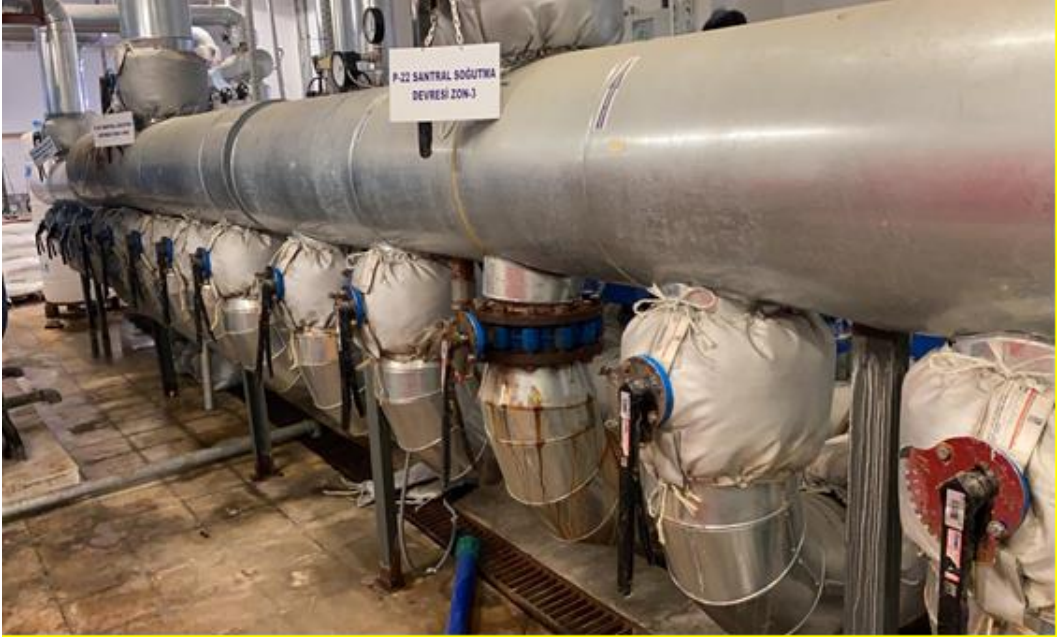
Fotoğraf 4. Santral Soğutma Devresi Tesisat Görünümü
