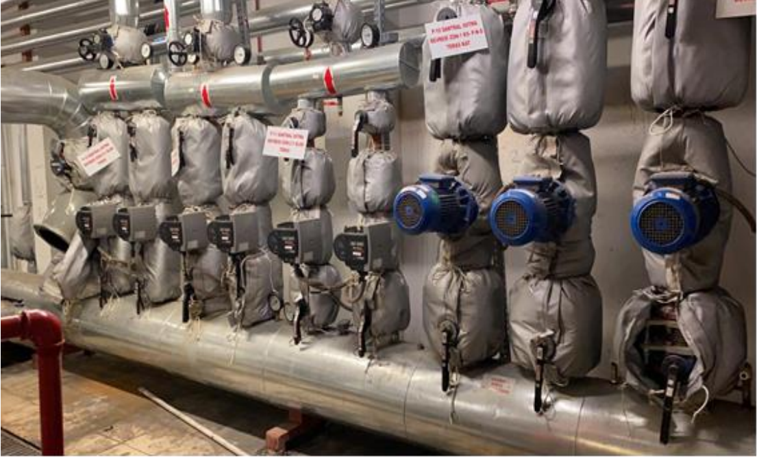
Fotoğraf 5. Isıtma Devresi Tesisat Görünümü
